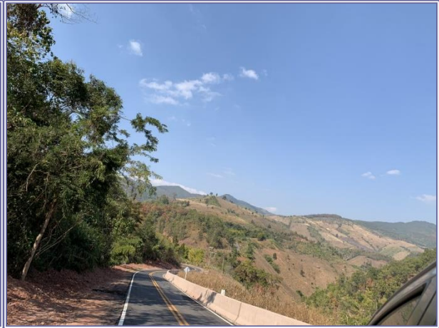
สภาพเส้นทางจากบ้านเปียงก่อ – บ้านกัวจันทร์ มีการปรับและซ่อมแซมเรียบร้อยแล้ว
